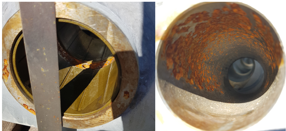
Abb. 2: Unzureichend Schmiermittel für Grundkorrosionsschutz aufgetragen
